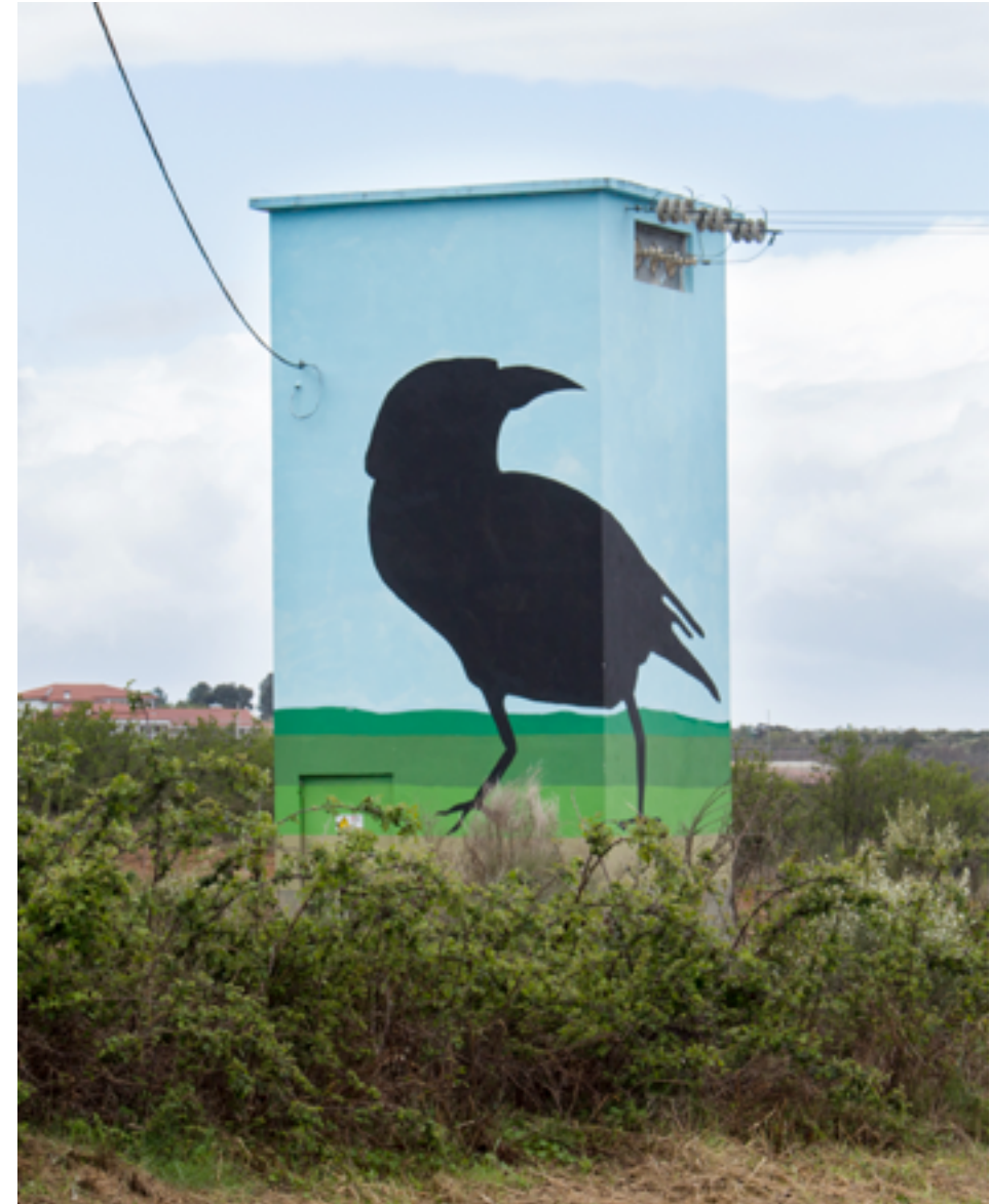
Habitado, MADEP/FBAUP students, EDP Distribuição transformation substation, Larinho, 2016.
