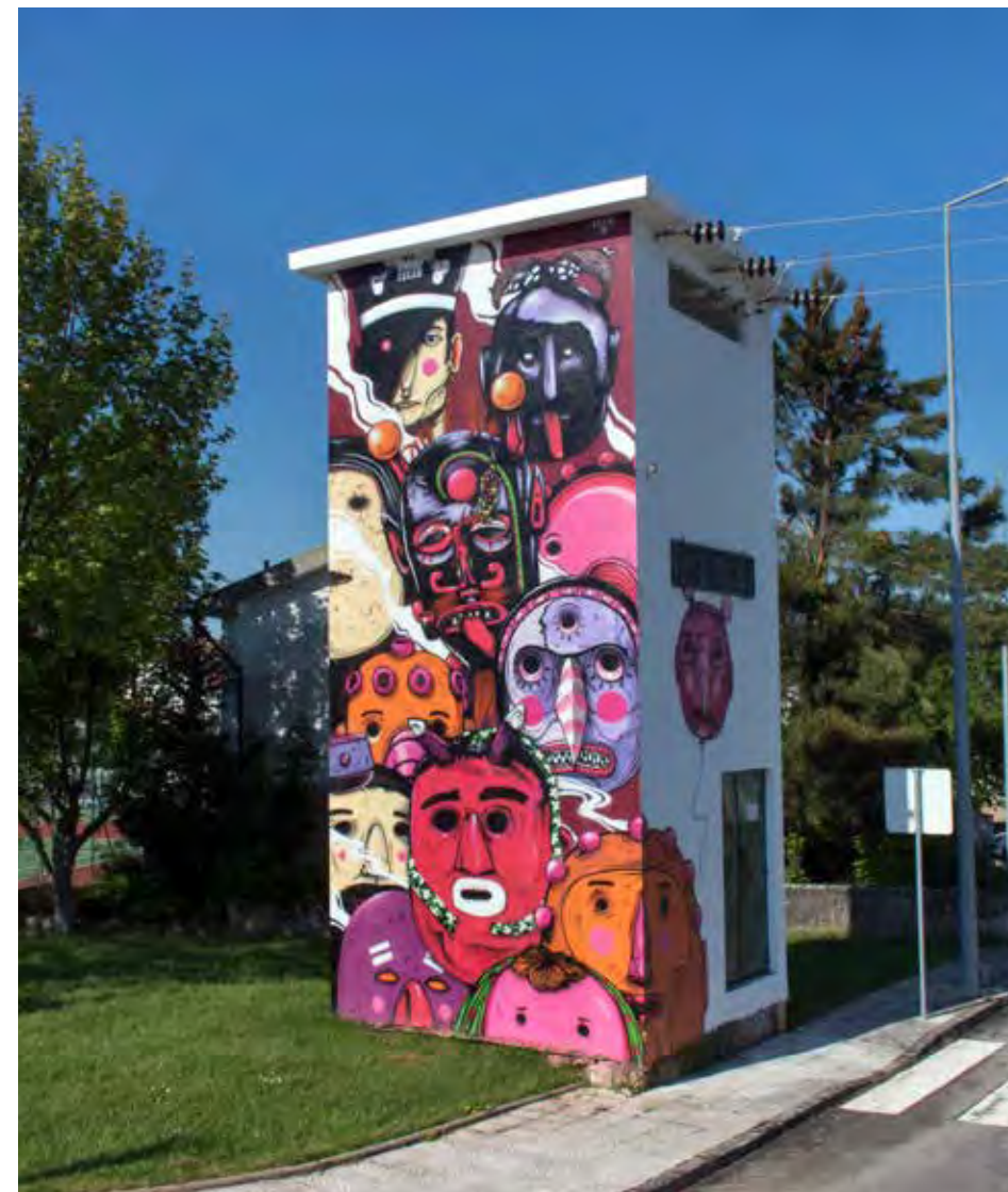
Más Caras, MAR, EDP Distribuição transformation substation, Mogadouro, 2018.
