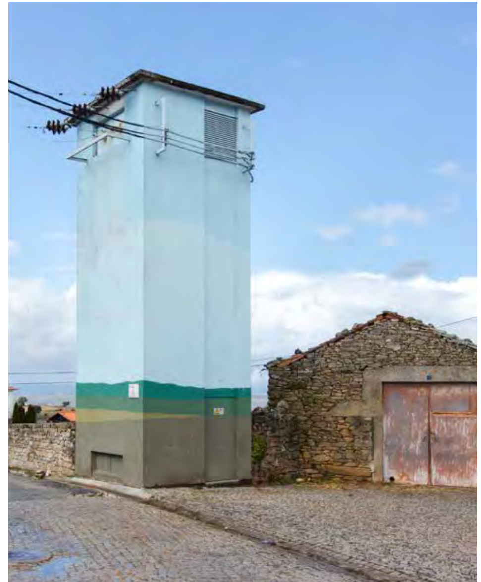
Desaparecido, MADEP/FBAUP students, EDP Distribuição transformation substation, Felgar, 2016.
